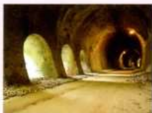
排煙口のある6号トンネル内部
